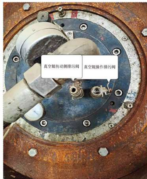
(b) 真空辊润滑喷淋水管排污照片
