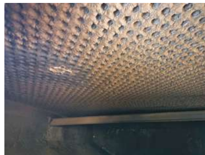
图13 袋通风汽-水热交换器孔板结垢
