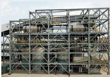
木片水洗+循环水处理系统
