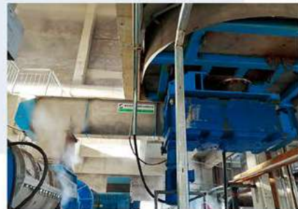
预蒸仓底部出料装置
