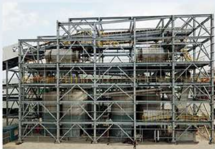
木片水洗+循环水处理系统
