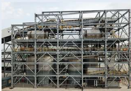
木片水洗+循环水处理系统
