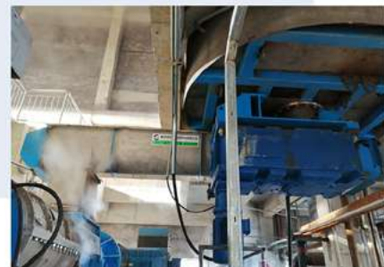
预蒸仓底部出料装置
