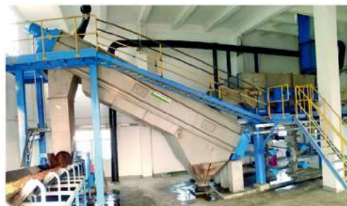
木片水洗及废水零排放处理系统 (最大处理能力：1200m 3 /h)
